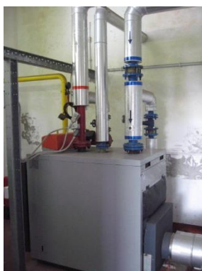
Figura 4.10 - Particolare della caldaia
