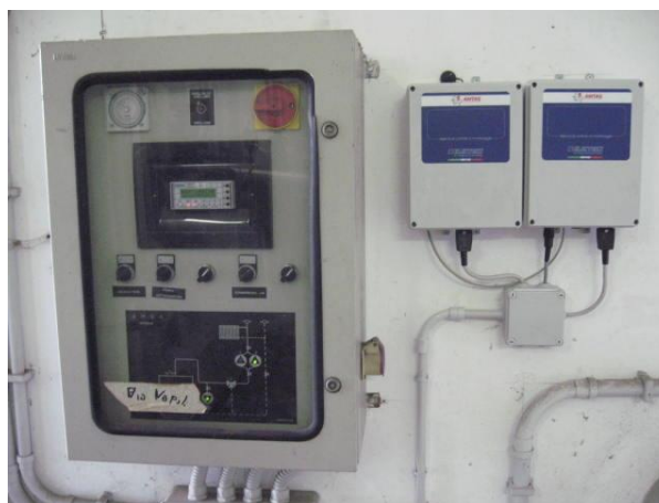
Figura 4.7 - Particolare della centraline di regolazione, telecontrollo e telegestione.
