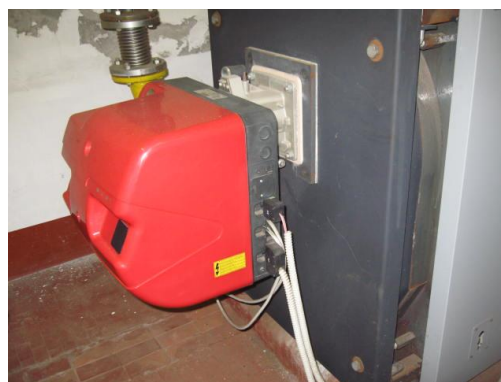
Figura 4.11 - Particolare del bruciatore
